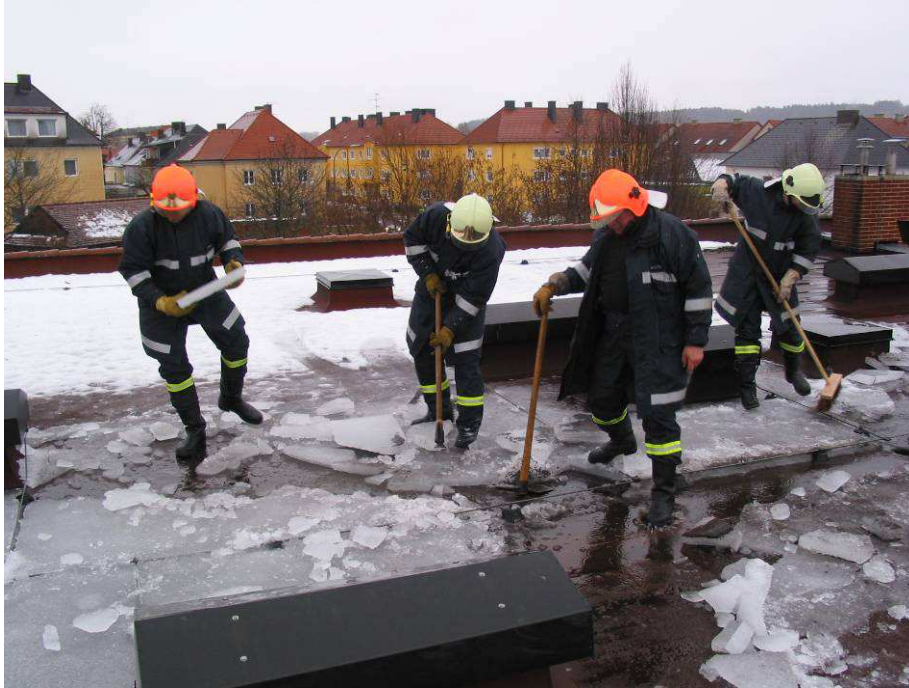
Wassereintritt bei Frisör Walter Stiftsstraße 18
