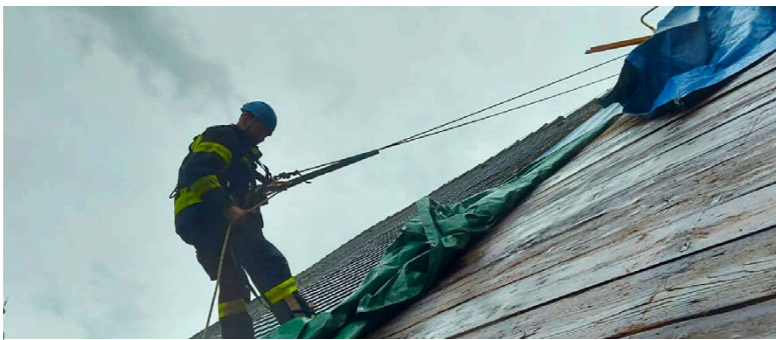
Abgedecktes Dach beim Stift St. Florian nach Unwetter
